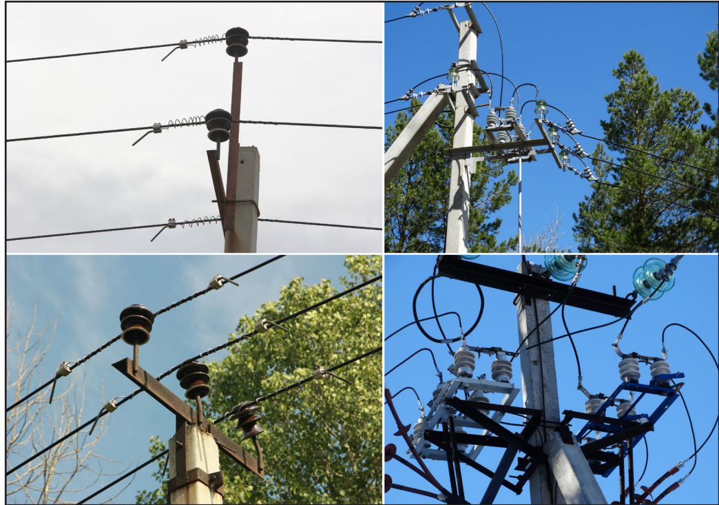
Рис. 14. Элементы грозозащиты без специальных ПЗУ на ВЛ 10 кВ с изолированным проводом (СИП-3): верху слева – Фидер 6 пс/т Дружба АО Татавтодор в Мензелинском районе; внизу слева – ВЛ в Рыбнослободском районе в лесном массиве западнее пос. Берсут (собственник не установлен). Птицеопасные неизолированные участки ЛЭП 10 кВ на анкерных опорах с разъединительными устройствами: верху справа – ЛЭП НГДУ «Прикамнефть»; внизу справа – ЛЭП Елабужских ЭС. Фото Р. Бекмансурова.
