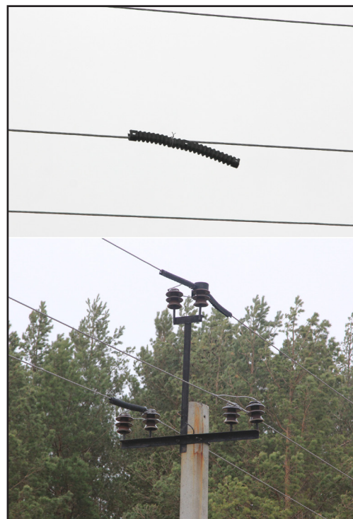
Рис. 12. Пример некачественного монтажа ПЗУ, приведший к их частичной потере (Елабужские ЭС). Закрепление пластикового кожуха алюминиевой проволокой является грубейшим нарушением технических требований монтажа, который может привести к гибели птиц. Фото Р. Бекмансурова.
