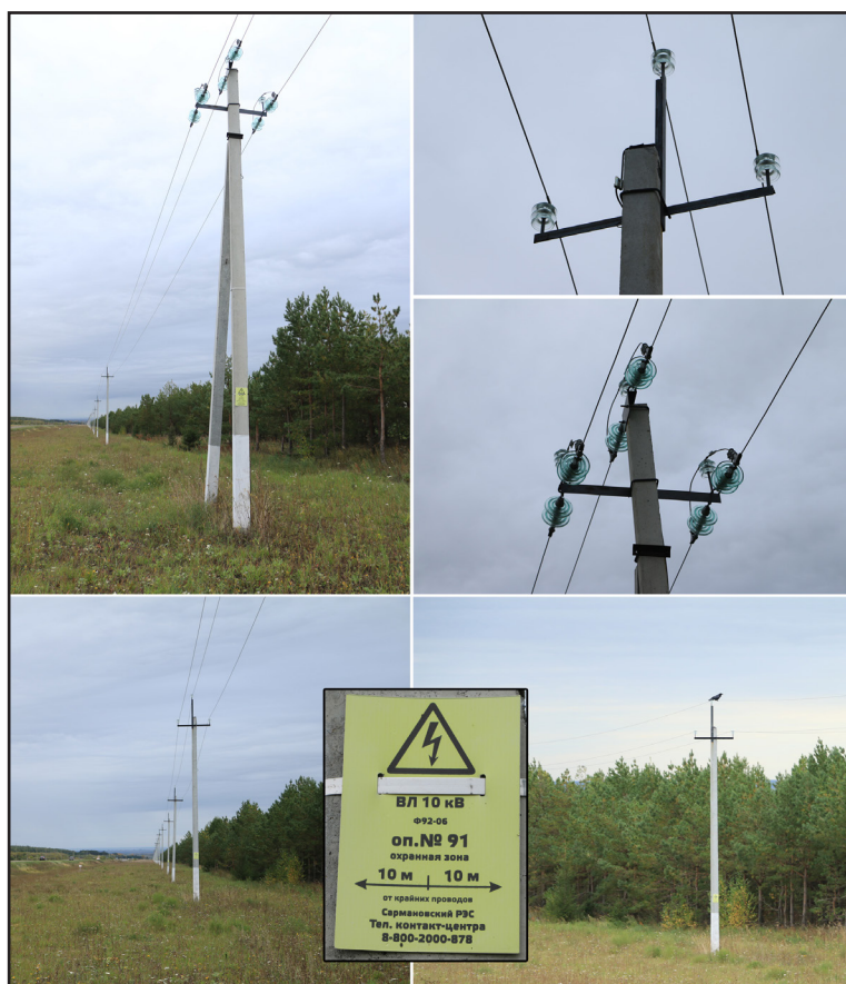
Рис. 13. Новая птицепасная ЛЭП 10 кВ, построенная вблизи райцентра Сарманово вдоль полигона ТБО, места сосредоточения птиц. Фото Р. Бекмансурова.
